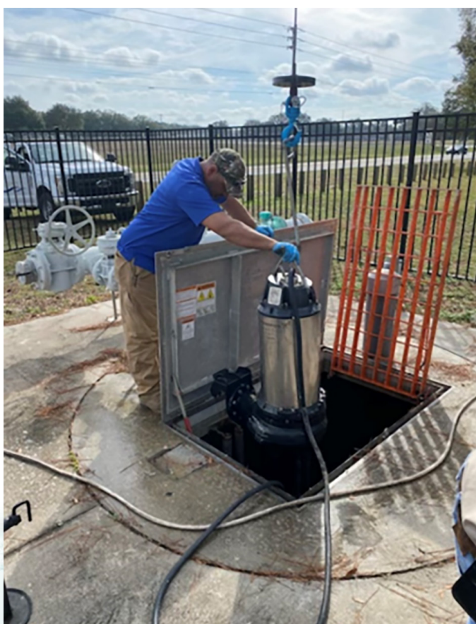
Instalación de una bomba SE para aguas residuales con el nuevo impulsor semiaabierto Open S-tube.
