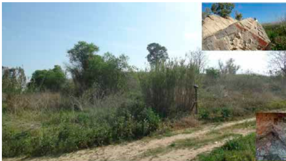
LOCALIZACIÓN DEL FUERTE DE TELENA. DETALLE DE MURO DESTRUIDO. Foto: M. Cayetano.
