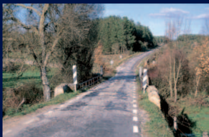
Estado deficitario da estrada Castilla de Flores Navasfrías
