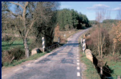
Estado deficitario de la carretera Castilla de Flores Navasfrías
