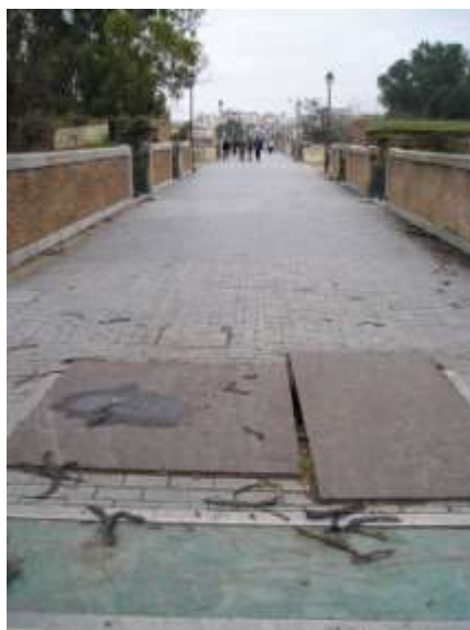
FOTO 22.- Planchas colocadas encima de los escudos después de que actos vandálicos destrozaran la mampara de protección, ejemplo de una equivocada decoración urbana.
