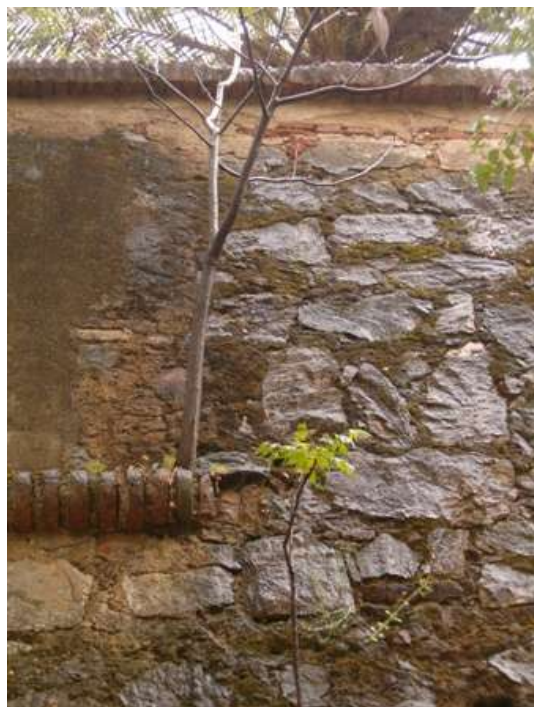
FOTO 14.- Vegetación invasora sobre la muralla
